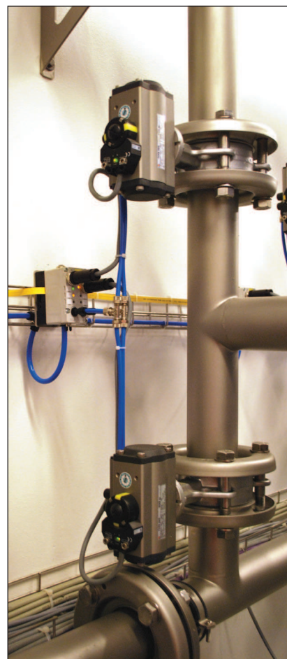
Hver af de tre grundvandspumper er også bestykket med ventiler og styringer fra Bihl+Wiedemann.
